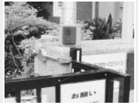
校門に設置されたカメラ付インターホン
